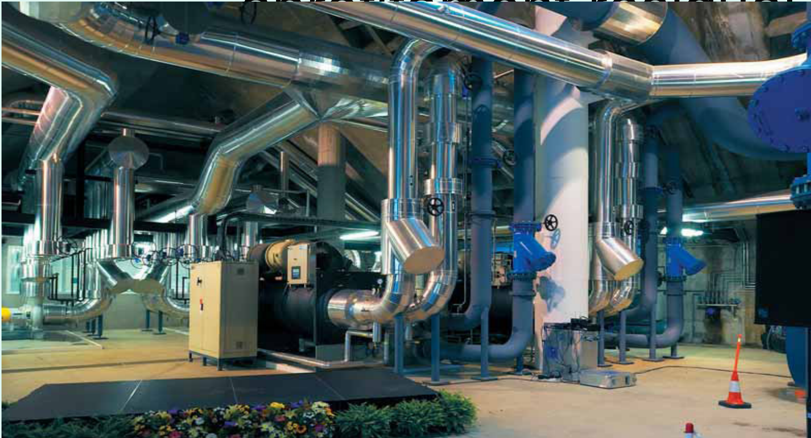
Central de producció d'aigua calenta i freda del fòrum (Barcelona)
